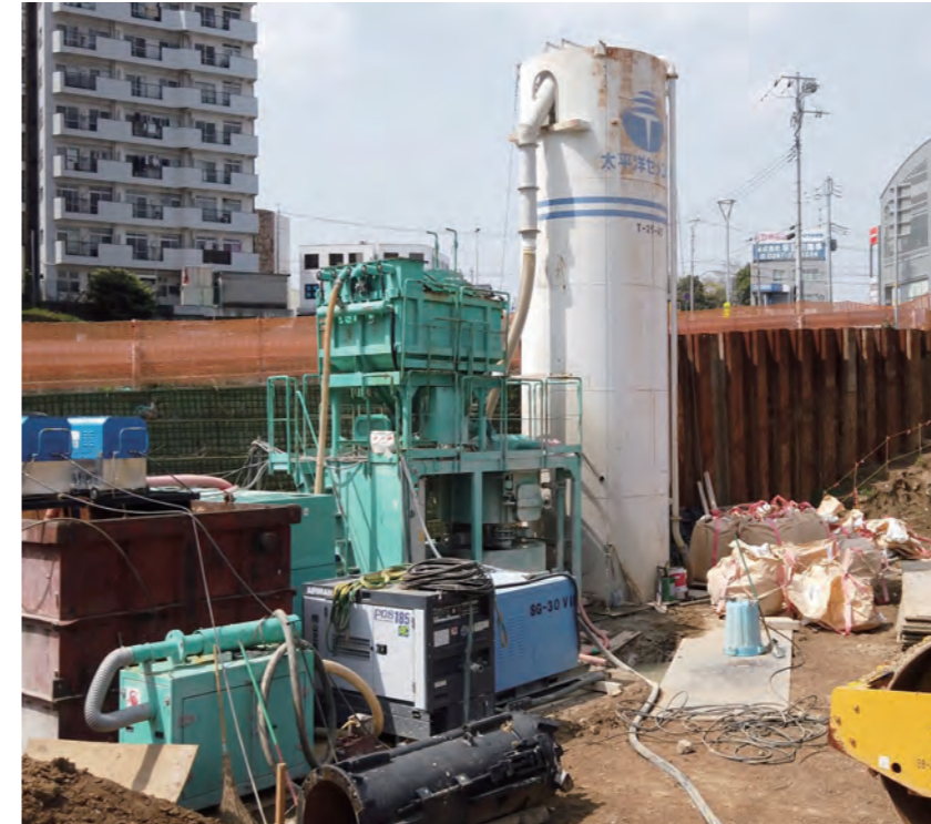
充填材作液プラント▲
